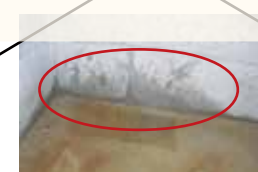
地下室漏水部分
